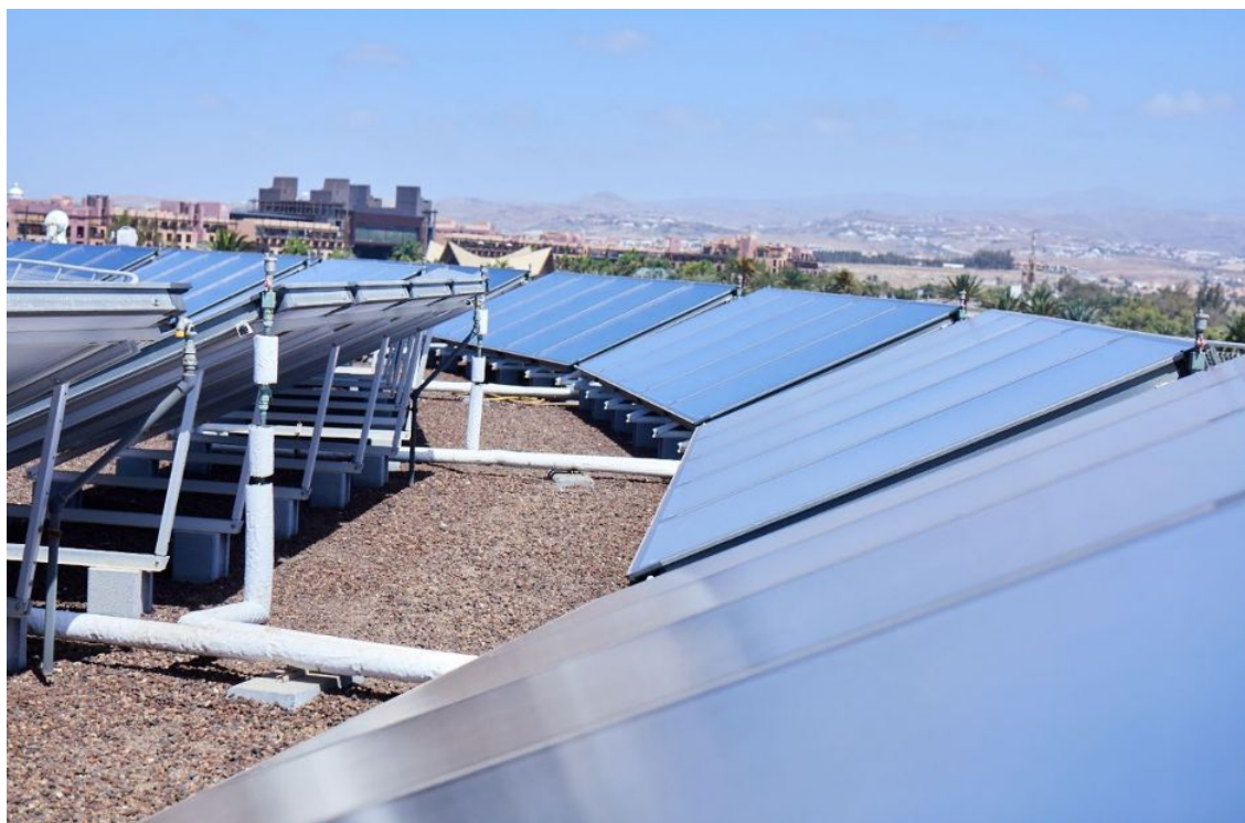
Ilustración 1 Placas solares térmicas Seaside hotel Palm Beach.
