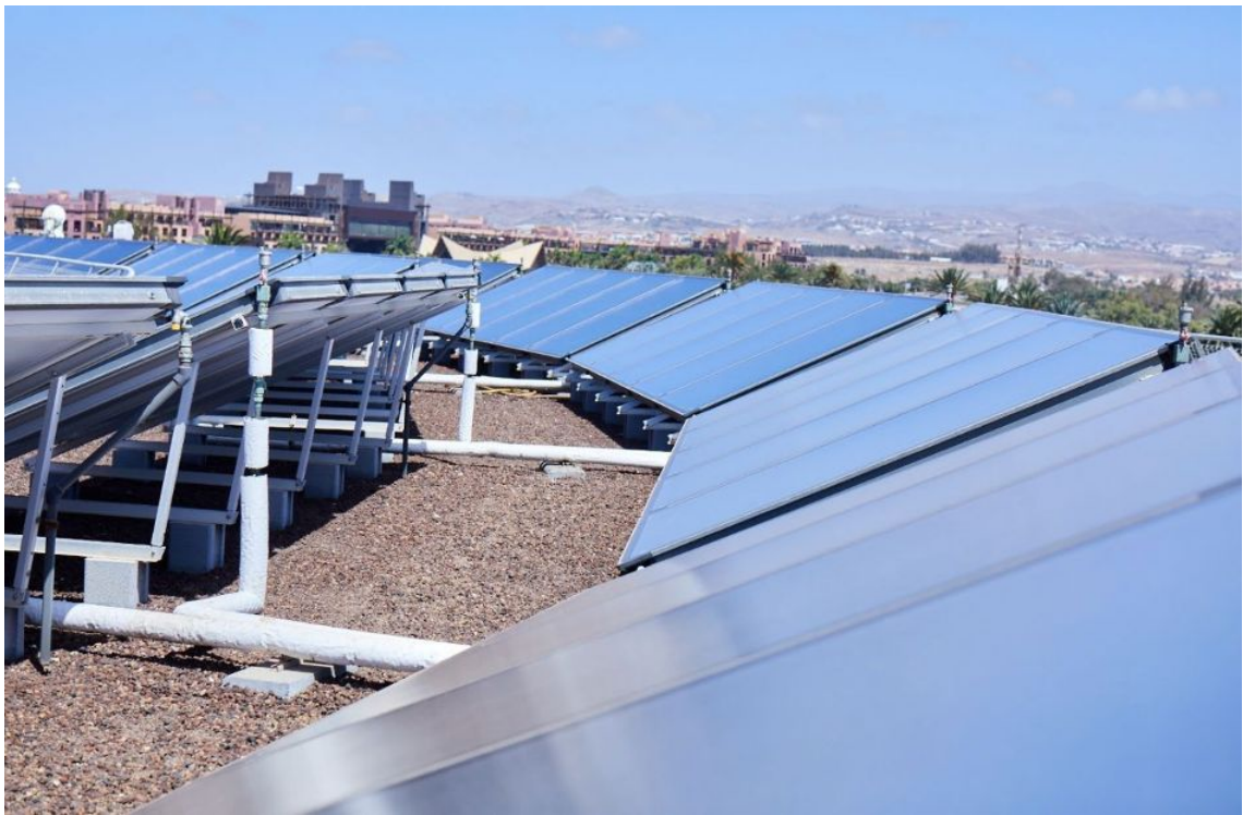
Abbildung 1: Thermische Sonnenkollektoren des Seaside Hotel Palm Beach.1
